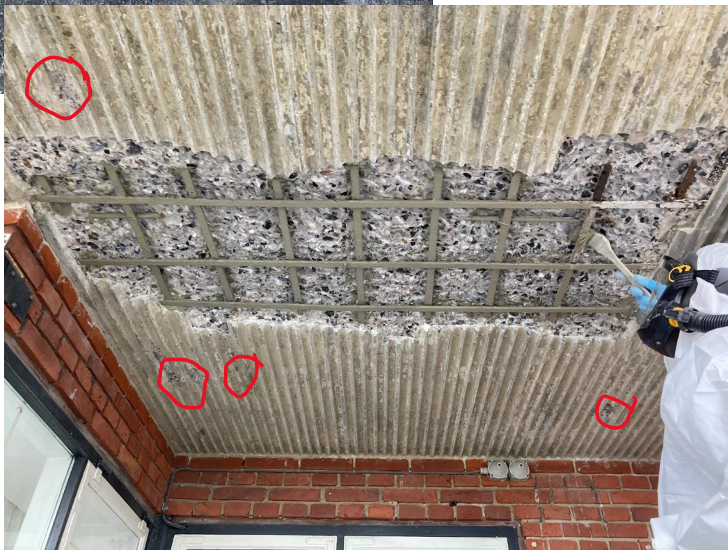
Synliggørelse af skader efter fjernelse maling
