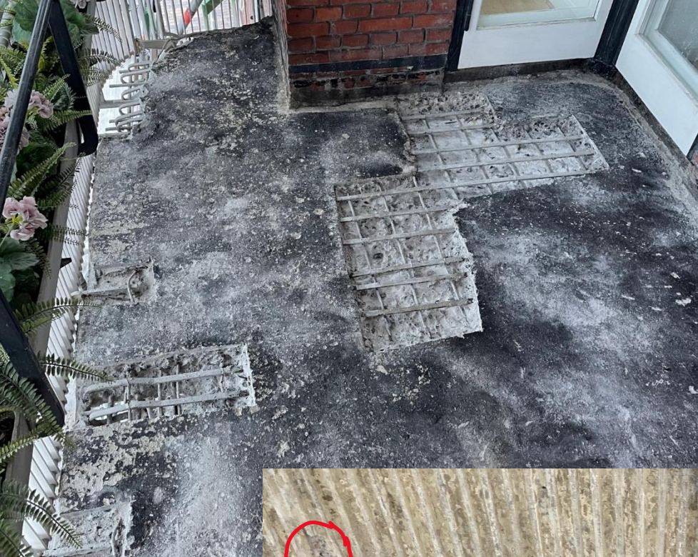
Synliggørelse af skader efter fjernelse af asbestplader
