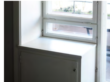
Skab og trævinduesplade i soveværelsesvindue.
